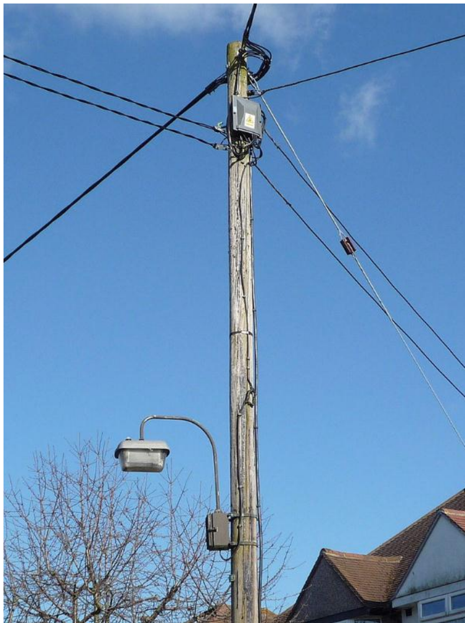
Самонесущий изолированный провод на деревянной опоре.
