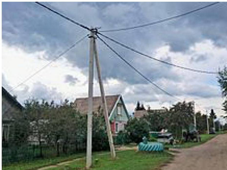
Самонесущий изолированный провод на железобетонной анкерной опоре, ЛЭП 0,4 кВ
