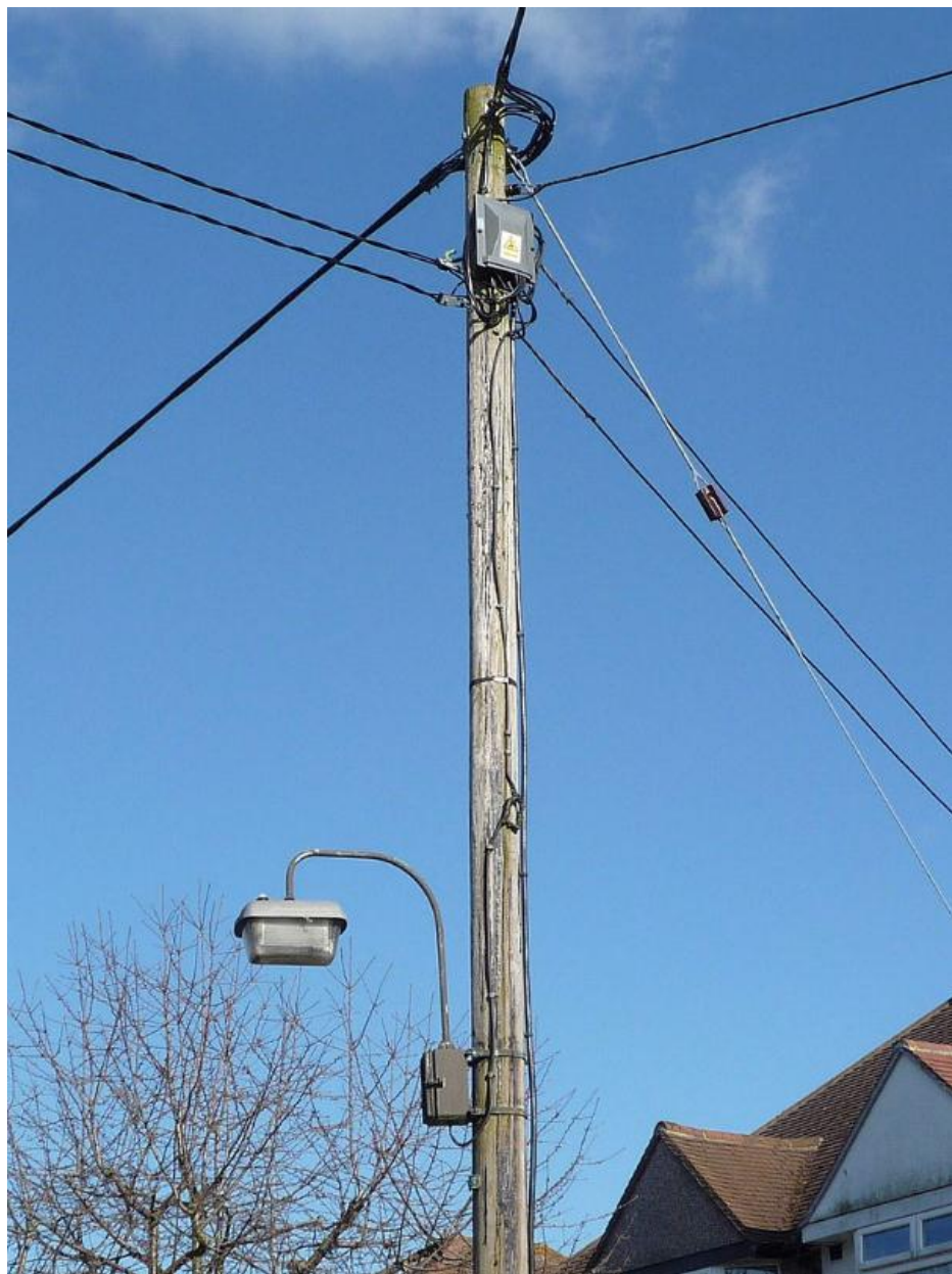
Самонесущий изолированный провод на деревянной опоре.
